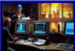
Plataforma de Control
