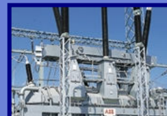
Transformadores de Potencia
